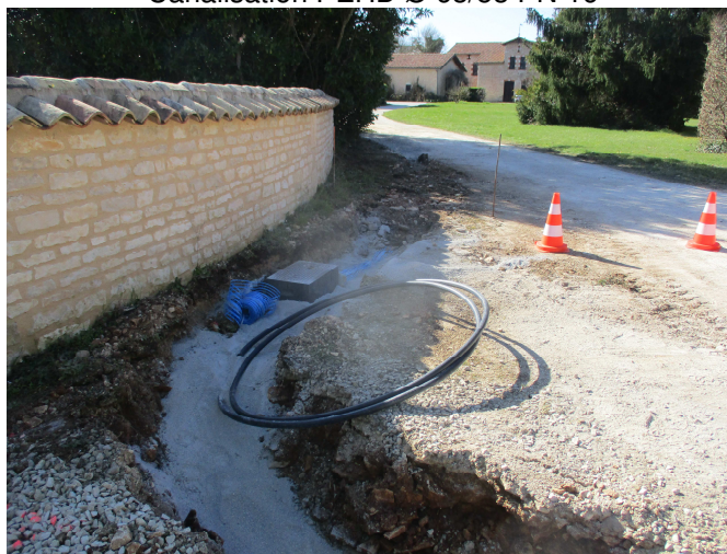
Niche à compteur posée « Chalet de la Boixe »
